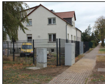
Multifunktionsgehäuse (MFG) der DATEL und Kabelverzweiger (KVz) der Telekom in Neecken
